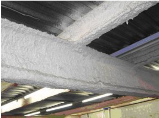
Harde asbestbepleistering op metalen steunbalken gespoten.
