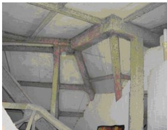
Spuitasbest met amosiet (niet ingekapseld) op metalen steunbalken en isolerende platen van het type « Pical ».
