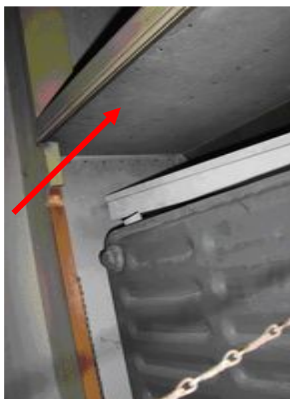
Asbestkarton (licht geplooid oppervlak) in een bekleding rond een radiator
