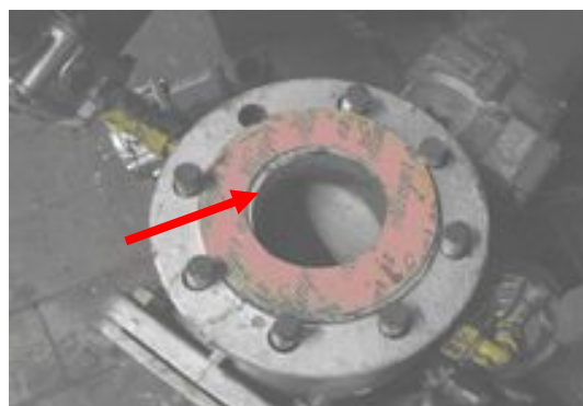
Asbestpakking van het type 'Klingerit' tussen de beugels van verwarmingsleidingen
