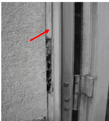
Asbesthoudende mastiek aan een vensterlijst
