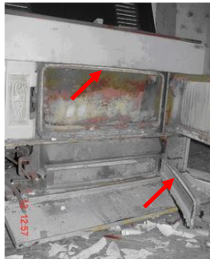
Koorden op de deurlijst van een kachel en op de deur van de roetschuif
