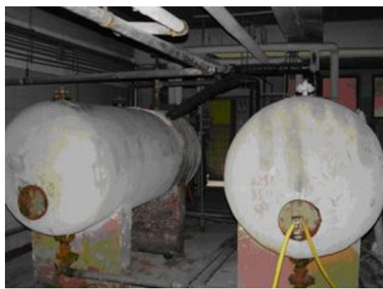
Warmwaterreservoirs bekleed met asbesthoudende pleister
