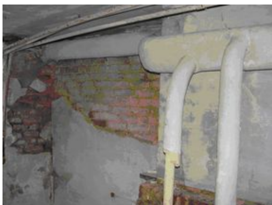
Oude éénlagige warmte-isolatie van asbestvezels bevattende diatomeeënaarde
