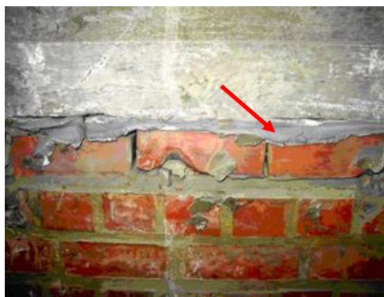
Uitzetvoeg in schuim met blauwe asbestvezels (ter hoogte van de overgang van de bovenkant van een muur en het betonnen plafond)
