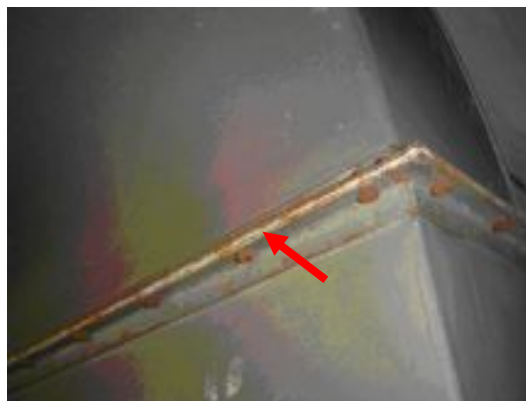
Fijn koord ter hoogte van de flens tussen twee ventilatiekoker-elementen
