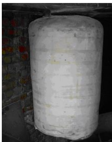
Met asbesthoudende pleister geïsoleerd expansievat
