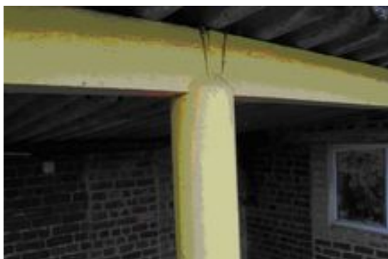
Leiding in asbestcement, gebruikt als verloren bekisting voor een steunpaal van een binnenplaats. De externe wafelstructuur is kenmerkend.
